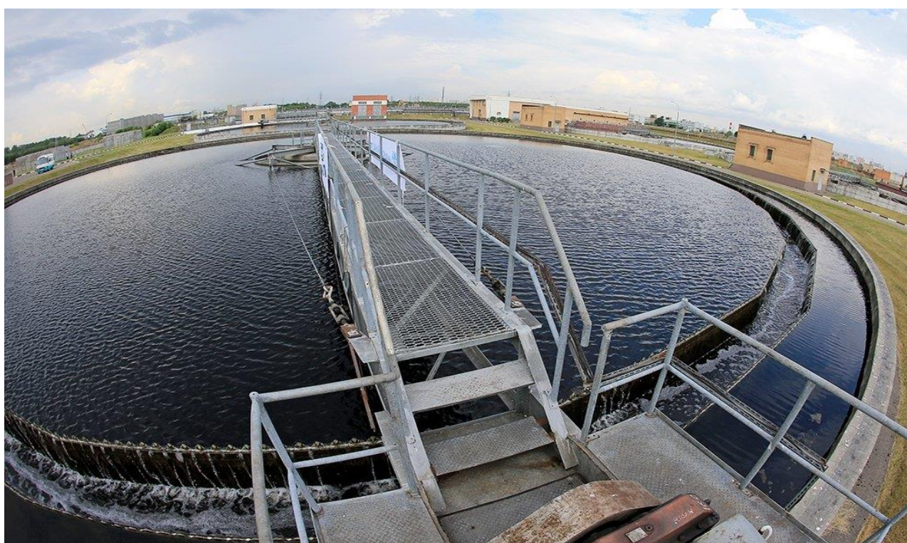
Рисунок 3. Москва. Люберецкие очистные сооружения Очистные сооружения канализации средних городов
